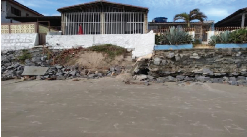
Figura 3 - Processo erosivo e degradação da infraestrutura das habitações residenciais da Praia da Redinha/RN
