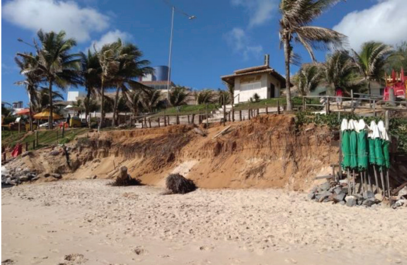
Figura 2 - Processo erosivo e degradação da infraestrutura da orla marítima da praia de Ponta Negra/RN
